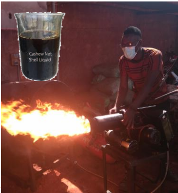
Brûleur à CNSL
